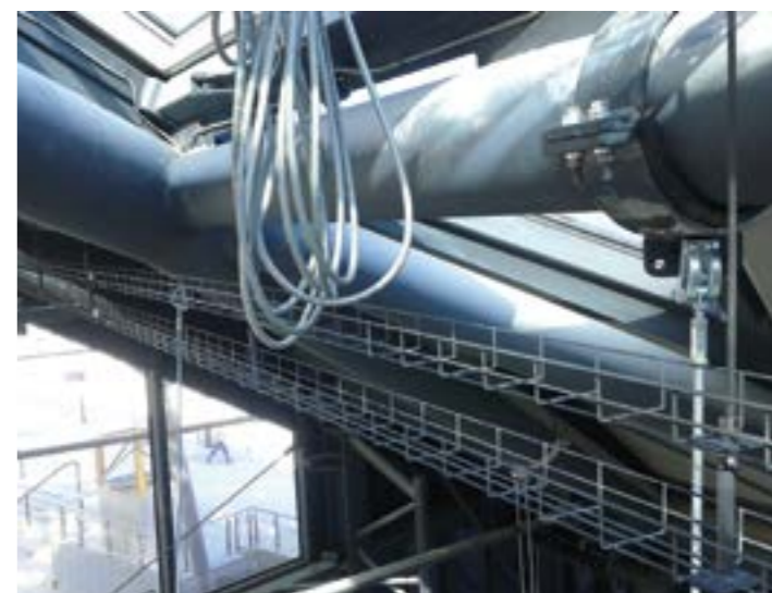
Fot. 1. Widok systemu nośnego siatkowych korytek kablowych do zasilania instalacji oddymiania grawitacyjnego.
