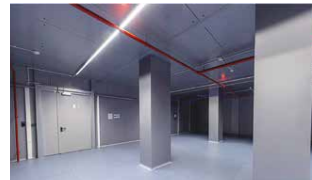
Wnętrze Talex Data Center
